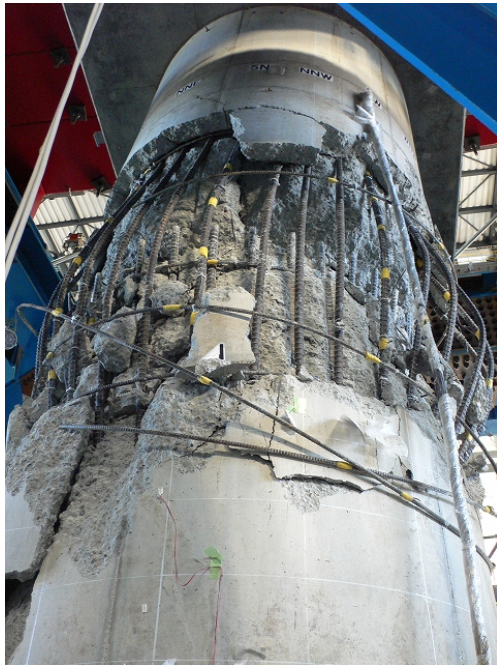
鉄筋コンクリート橋脚の損傷
